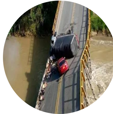
Caída de escombros y otros
