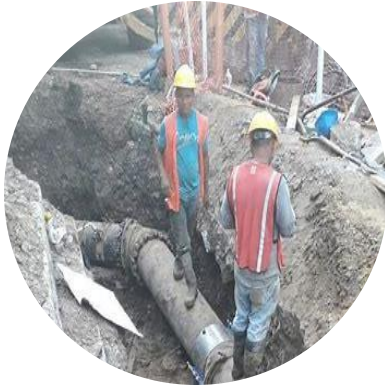
Impactos a tuberías
